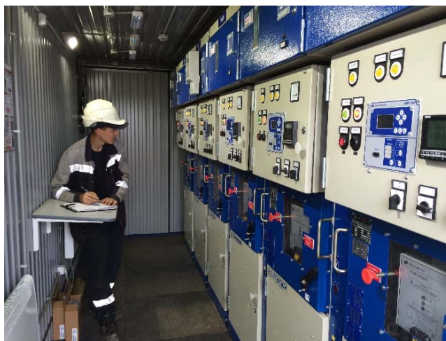
Рис. 3 Внутренний вид КРУ-6 кВ.
